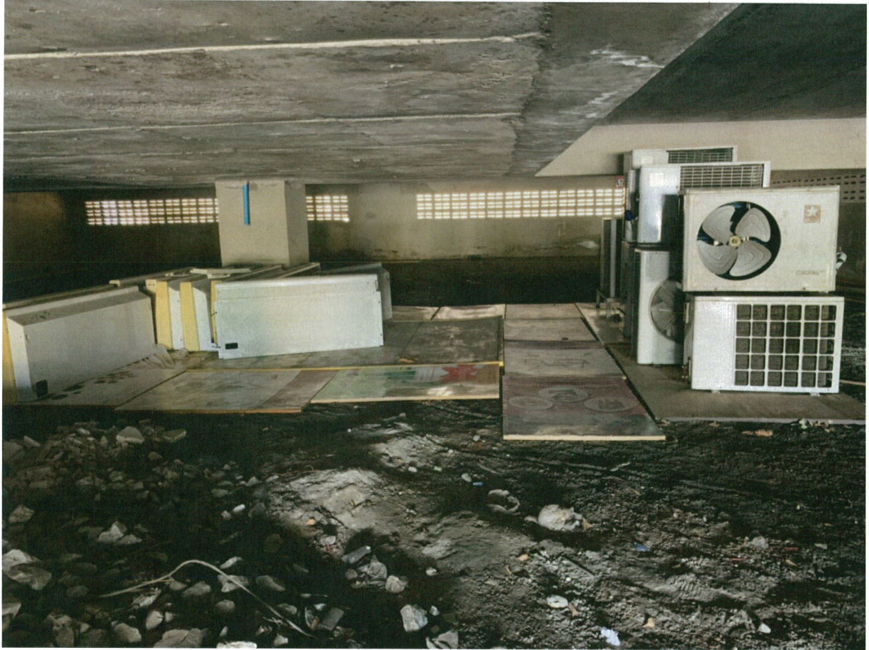
ภาพครุภัณฑ์ชำรุด เสื่อมสภาพจากการใช้งาน เครื่องปรับอากาศ จำนวน 11 เครื่อง
